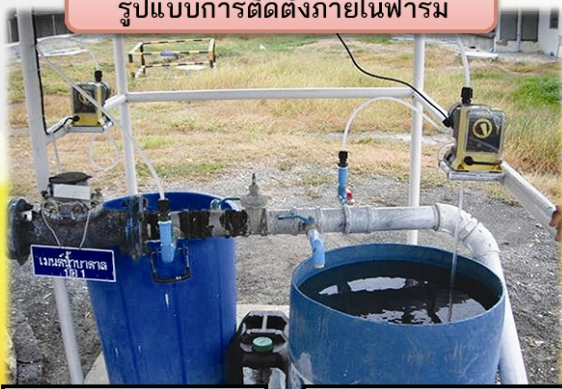
รูปแบบการติดตั้งภายในฟาร์ม
